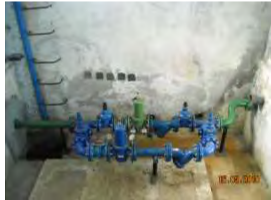
Válvula reductora presión, Camino de la Serna
