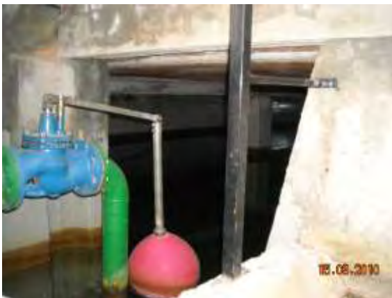
Vista vaso del depósito
