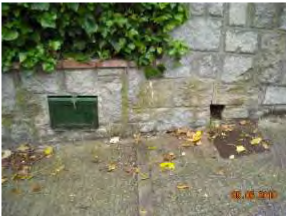
Acometida no conforme
