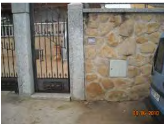
Acometida no conforme, sin llave de acera
