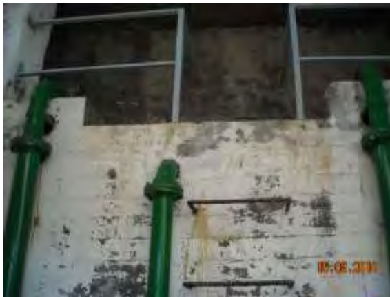
Tuberías de entrada y rebosadero
