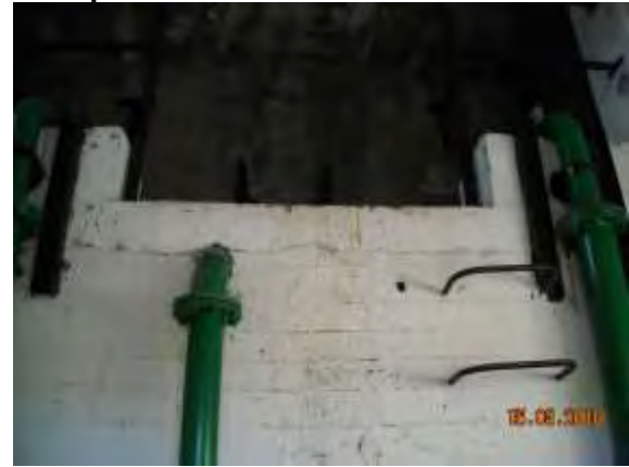
Tuberías de entrada y rebosadero
