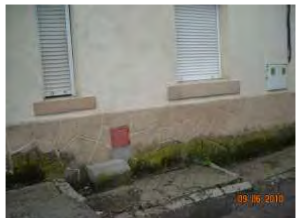
Acometida no conforme, sin llave de acera
