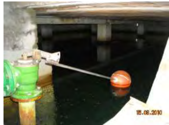
Vista vaso del depósito
