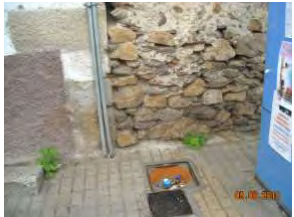
Acometida no conforme
