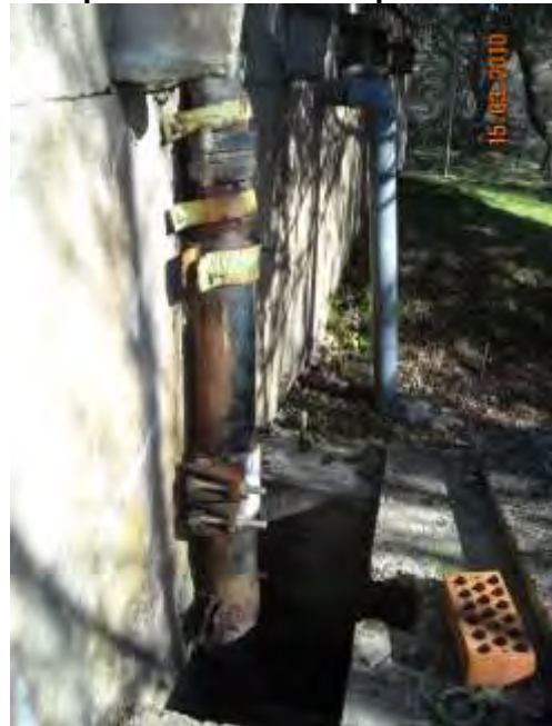
Tubería de entrada
