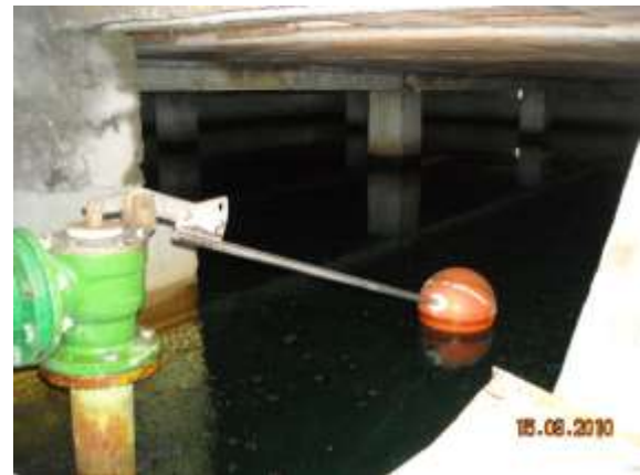
Vista vaso del depósito
