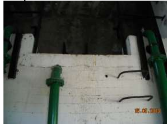
Tuberías de entrada y rebosadero
