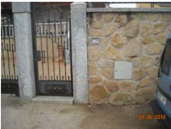
Acometida no conforme, sin llave de acera
