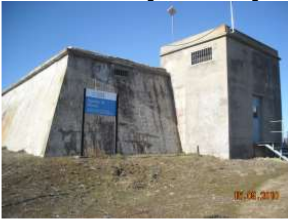
Vista del depósito
