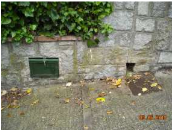
Acometida no conforme
