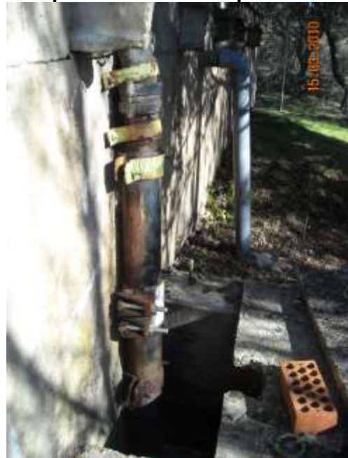
Tubería de entrada
