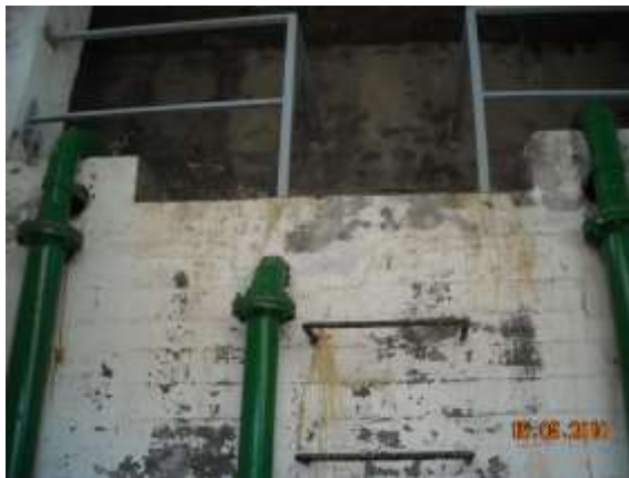
Tuberías de entrada y rebosadero
