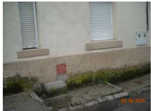
Acometida no conforme, sin llave de acera
