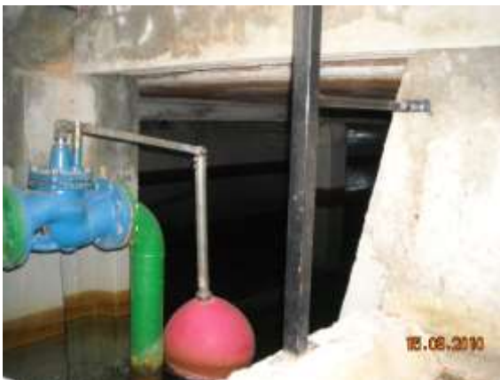
Vista vaso del depósito
