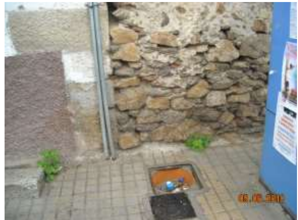
Acometida no conforme
