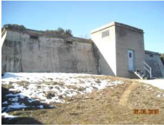
Vista del depósito
